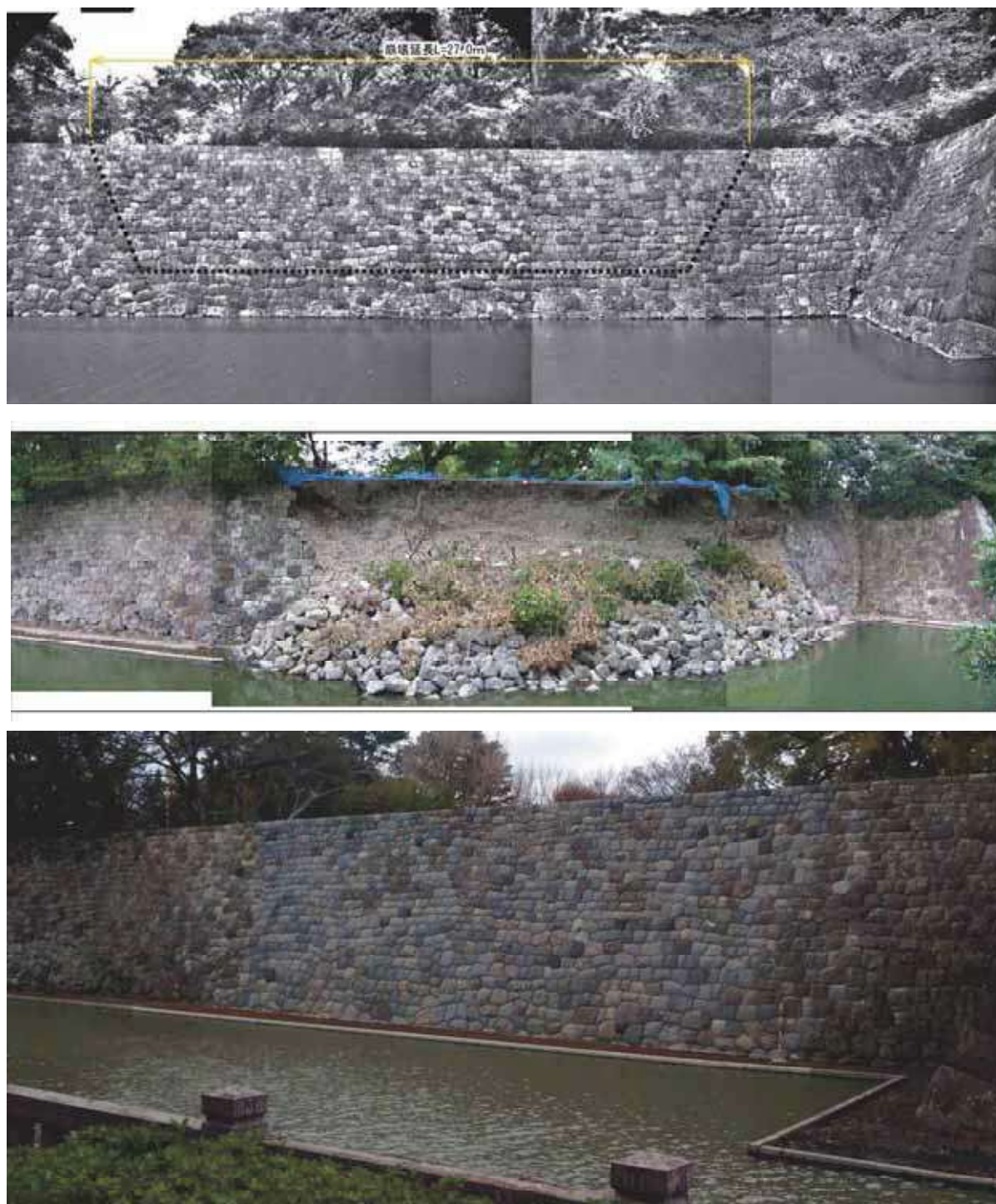
図-1 崩落前、崩落後、工事完了後の石垣正面
