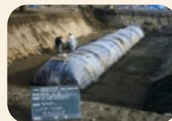
耐震性貯水槽
