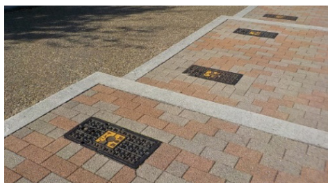
防災施設(神戸震災復興記念公園)[神戸市]
